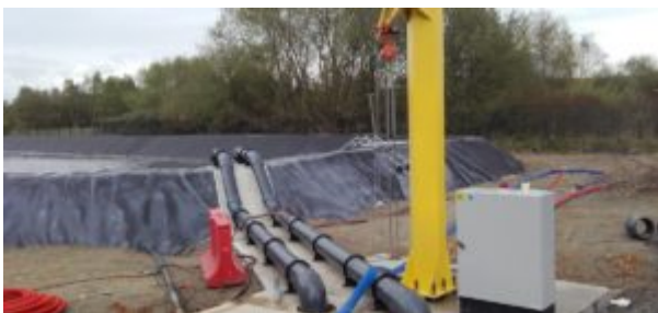
L'armoire de commande, les tuyaux de refoulement et le bassin
