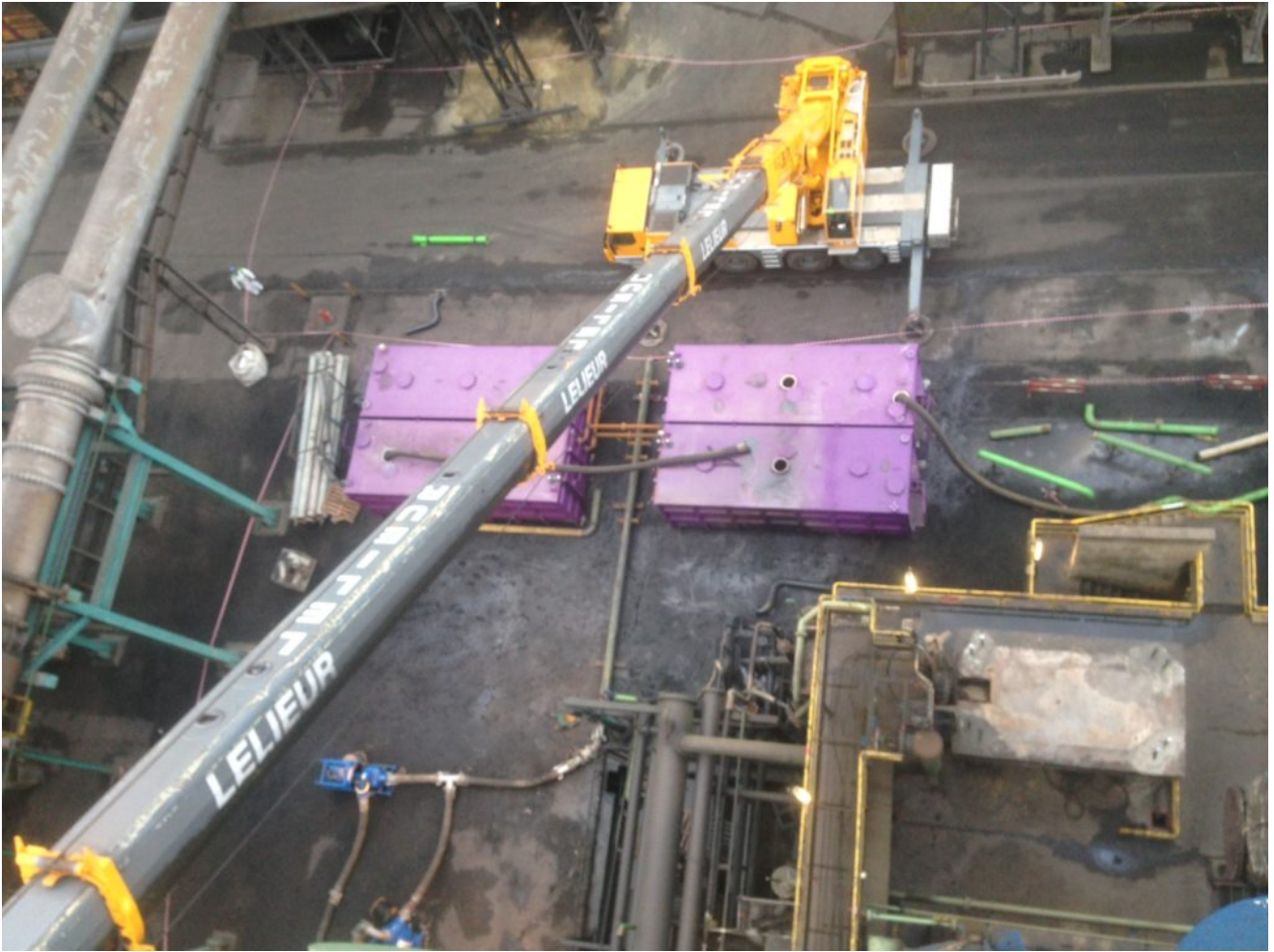
Le by-pass avec les deux Varisco et les réservoirs tampons
